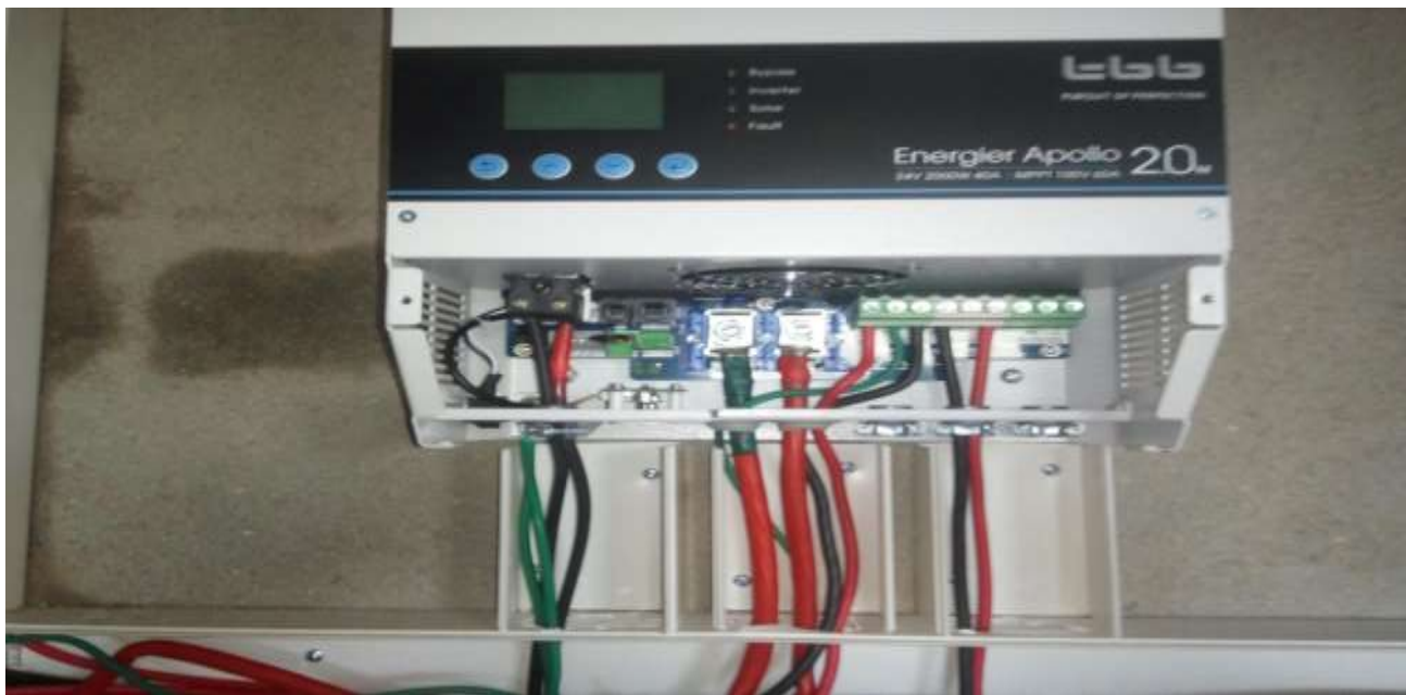
Elektrischer Anschluss Solaranlage
